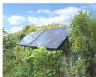
Les capteurs thermiques sont adossés à un mur du jardin. Cette solution demande une surveillance de la croissance de la végétation pour éviter toute ombre portée. Vigny (Val d'Oise) © PNR du Vexin français
